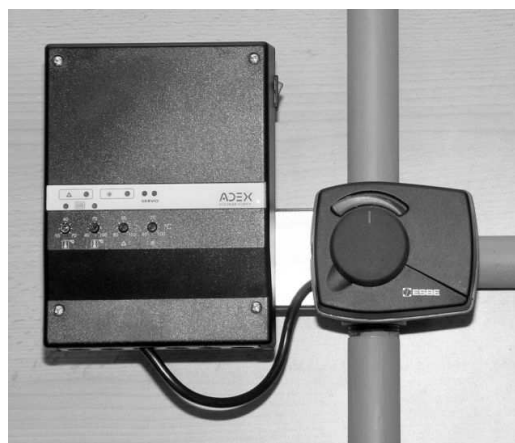
Obr. 16 Směšovací ventil ESBE se servopohonem a regulátorem upevněným na držáku.
